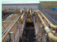
Bild 1: Chemanlage mit GFK-Rohren
